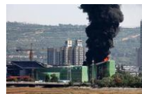
在建楼失火 现场起几十米黑烟
