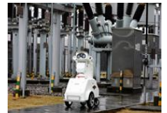
“高科技”助力电网巡检
